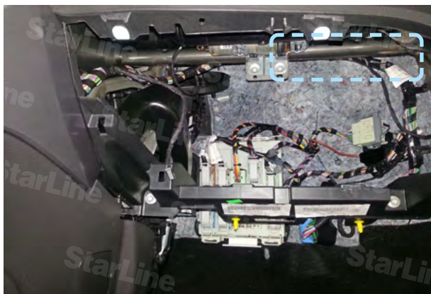
Фото 5. Пример расположения центрального блока охранно-телематического комплекса
