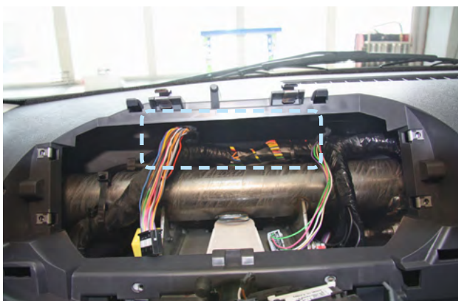
Фото 2.8. Пример расположения центрального блока охранно-телематического комплекса
