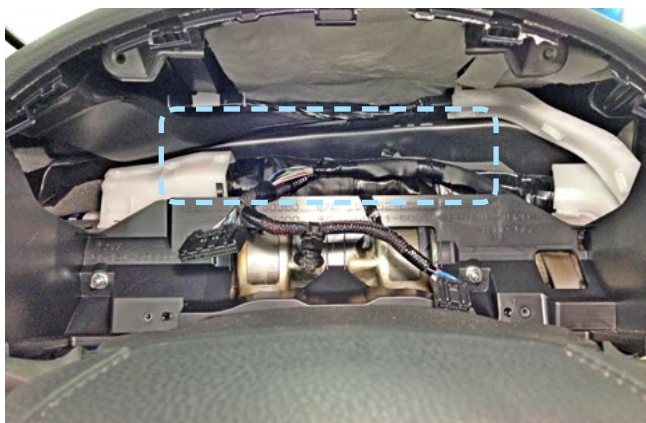
Фото 2.8. Пример расположения центрального блока охранно-телематического комплекса
